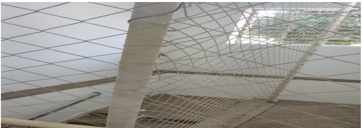
Tela de proteção nas escadas do interior do prédio do Instituto Raul Soares Fonte: arquivo pessoal.
