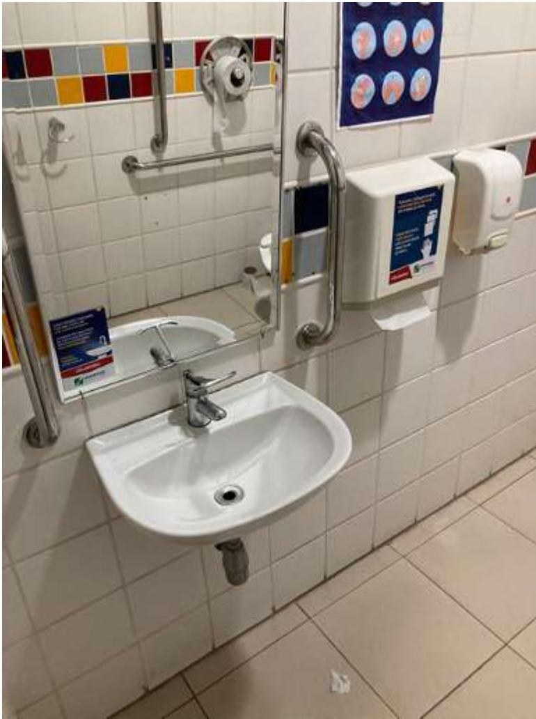
Pia do sanitário acessível
