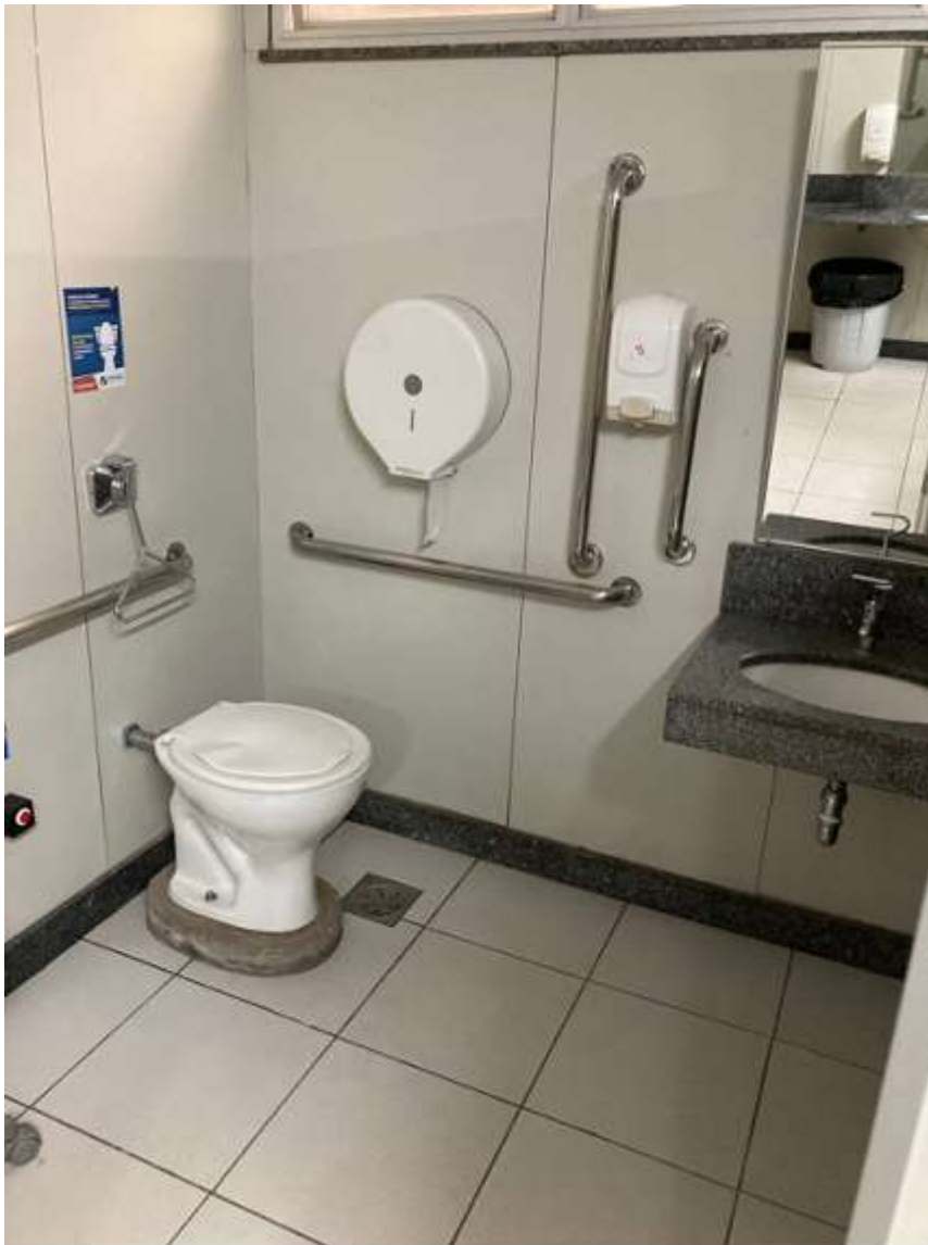
Vaso de Sanitário acessível
