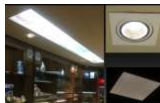
Figura 05. Luminárias da loja da padaria.
